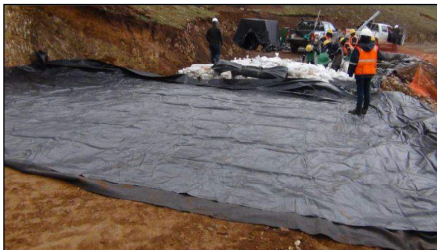
Figura N°37. Instalación de la Geomembrana de Polietileno de 0,75 mm. Fuente: Informe Maccaferri Proyecto de Exploración Hilarión, (2013).
