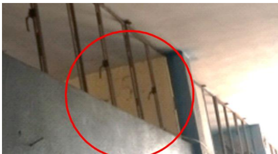
Figura 56. Presencia de fisuras en viga-columna justamente en la intersección entre ambos
