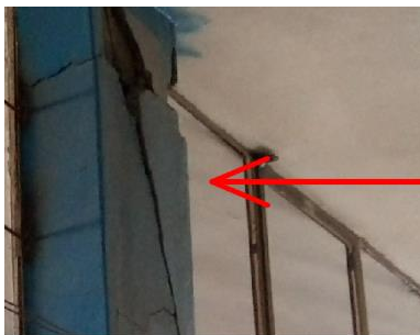
Figura 57. Fisuración por retracción por exceso de desplazamiento
