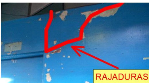
Figura 27. Rajaduras en los muros de albañilería por fisuras diagonales
