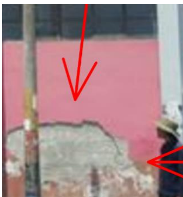
Figura 54. Desprendimiento del recubrimiento en muros.
