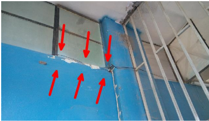
Figura 53. Fisura de orden de 0.1 mm a 0.2 mm.
