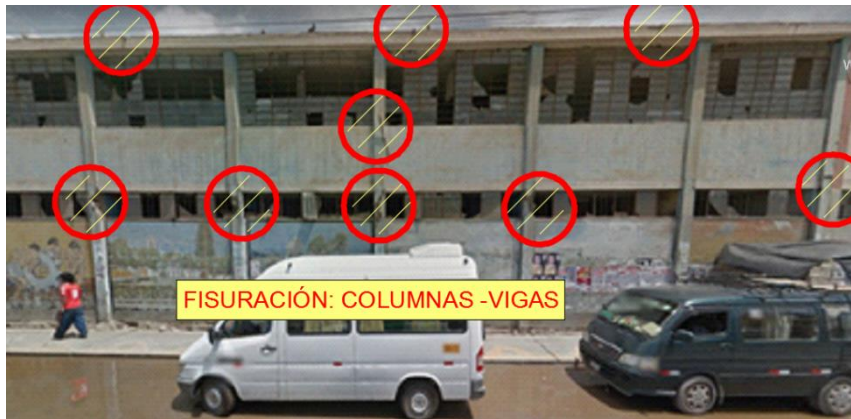
Figura 55. Fisuras por esfuerzo en columnas y vigas, desprendimiento de concreto en columnas
