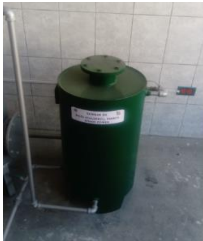
Figura 3. Tanque de salmuera
