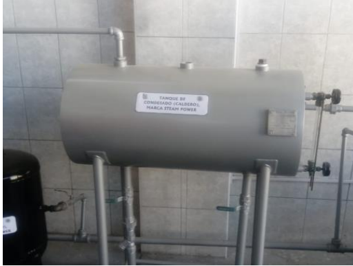
Figura 4. Tanque de condensado
