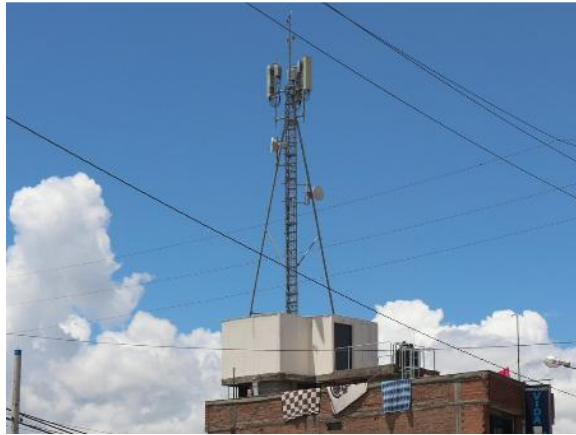
Figura 17. Torre de antena de celular sobre una casa
